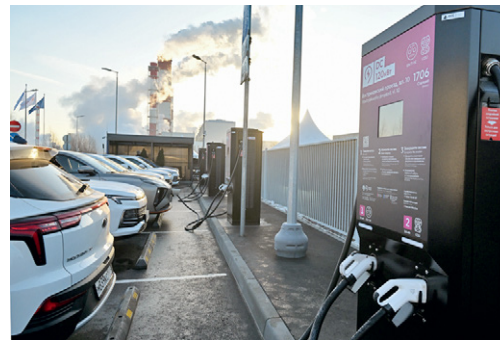
Электрохаб расположен рядом с одной из крупнейших электростанций Москвы – ТЭЦ-26. Одновременно здесь могут заряжаться до 20 электромобилей
