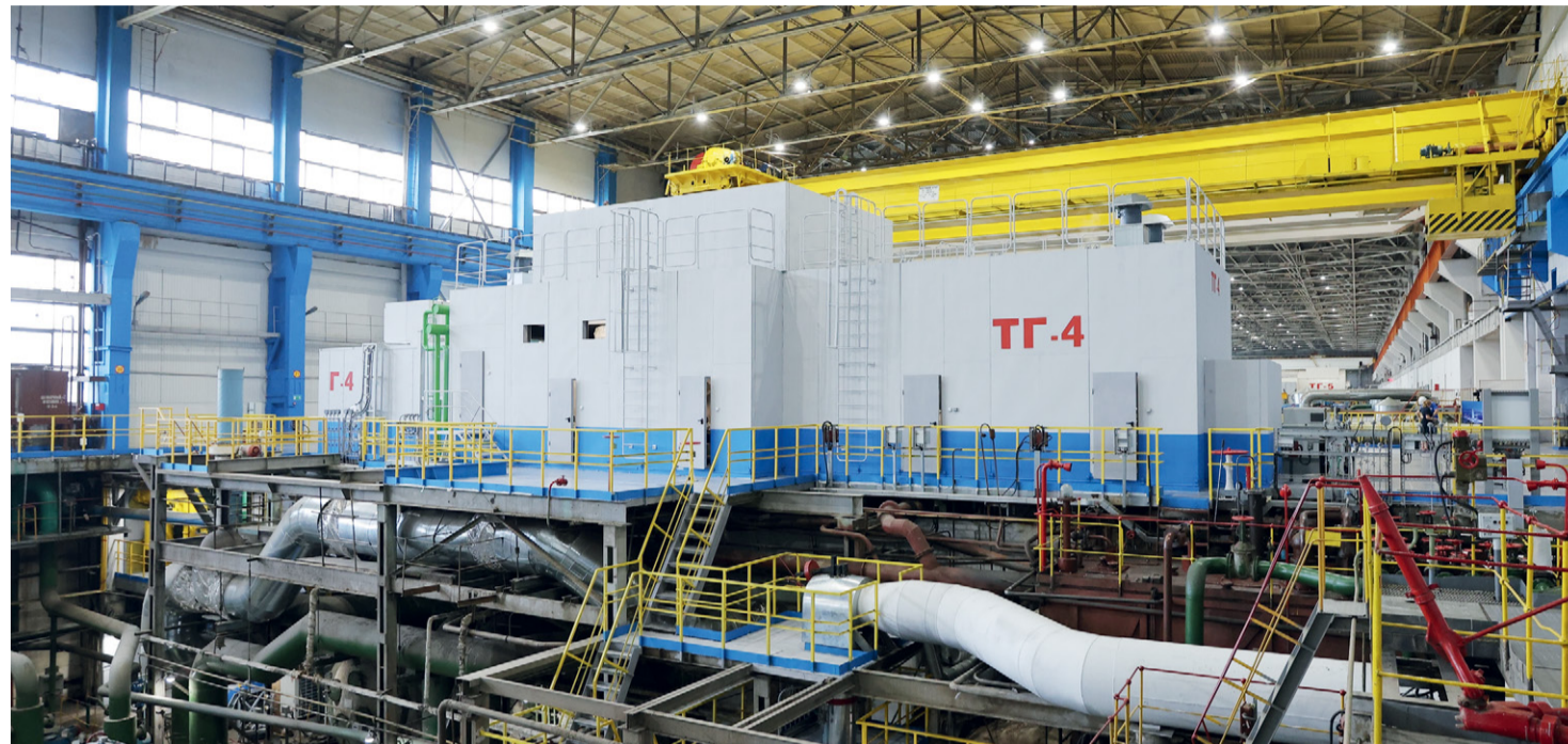
Турбоагрегат № 4 ТЭЦ-23, введенный в эксплуатацию в июне 2024 года
