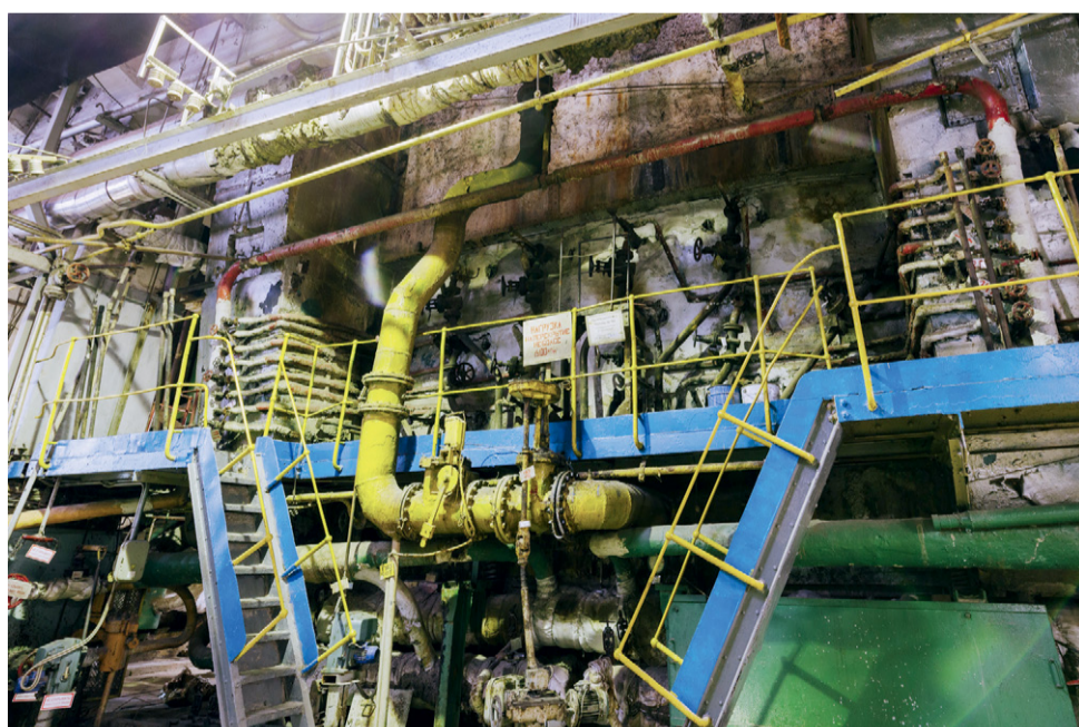
ЭК № 5, эксплуатировавшийся на ГЭС-1 с 1931 года
