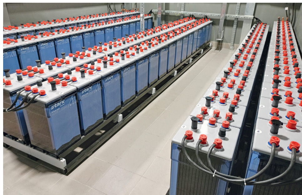
Аккумуляторные батареи энергоблоков № 7, 10 ТЭЦ-11 им. М. Я. Уфаева
