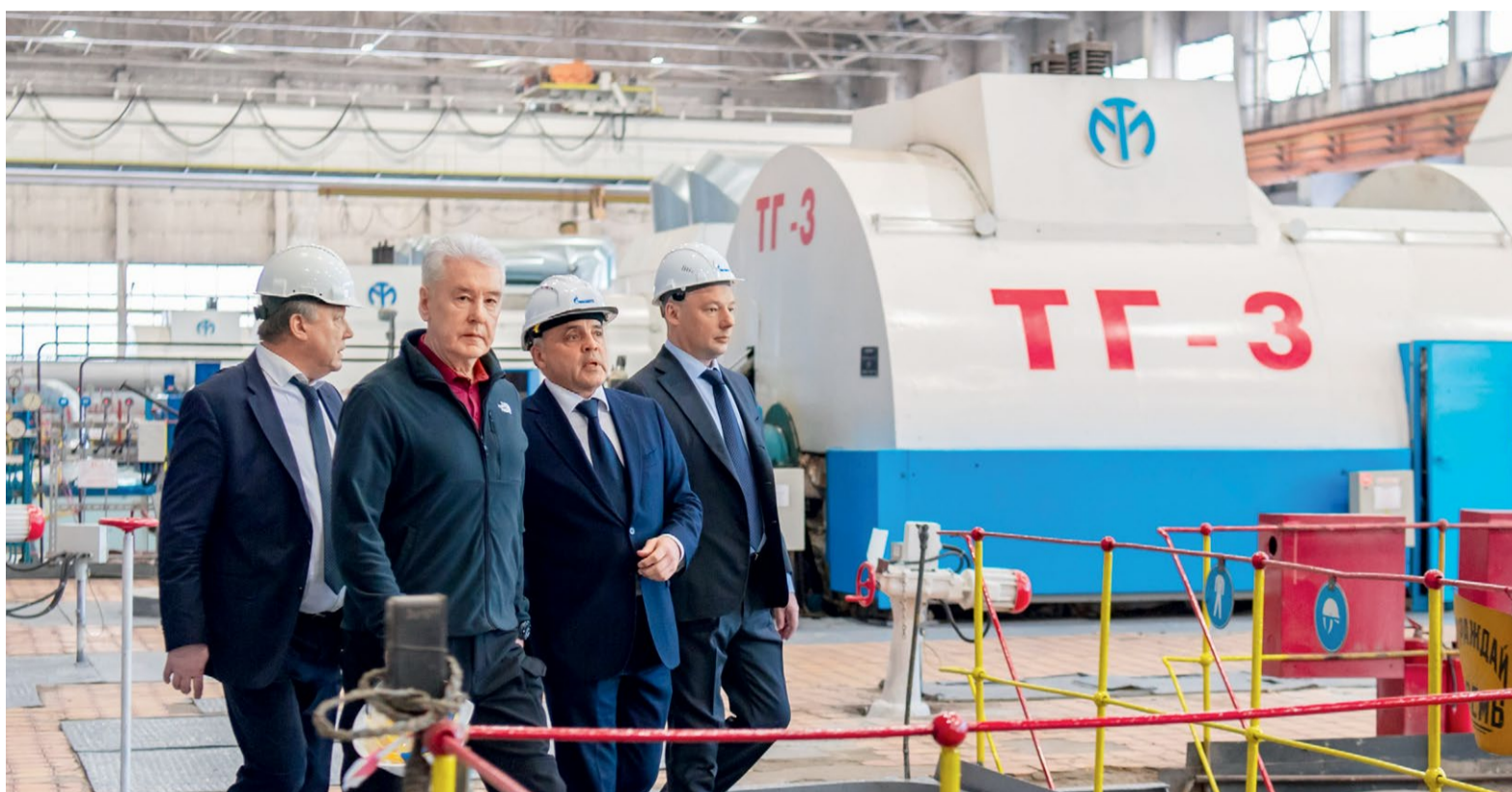
В машинном зале ТЭЦ-23 (слева направо): директор ТЭЦ-23 Юрий Громов, Мэр Москвы Сергей Собянин, управляющий директор ПАО «Мосэнерго» Александр Бутко и генеральный директор ООО «Газпром энергохолдинг» Денис Федоров
