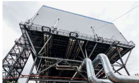
«Сухая» градирня блока ПГУ-220 ТЭЦ-12
