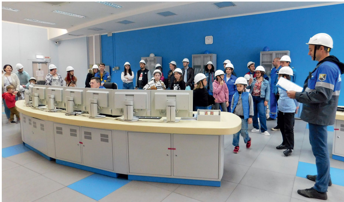
На щите управления энергоблоком ПГУ-420
