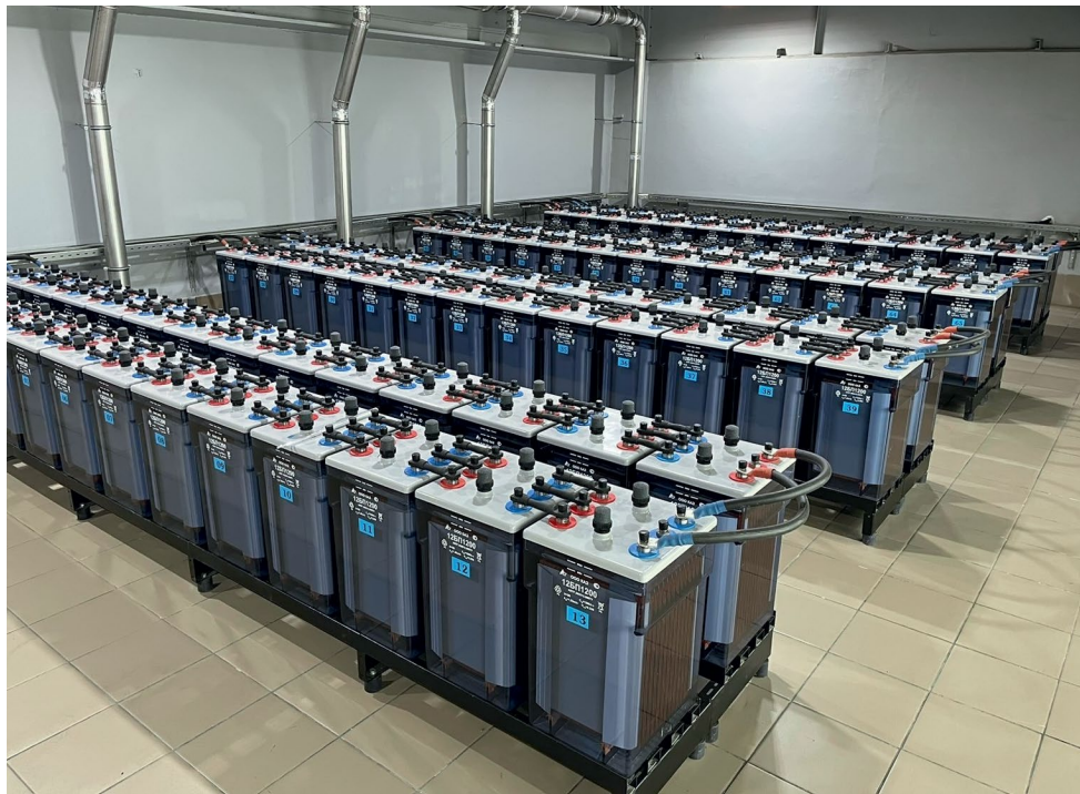
Аккумуляторные батареи энергоблока № 11 ТЭЦ-22, установленные в рамках модернизации системы оперативного постоянного тока
